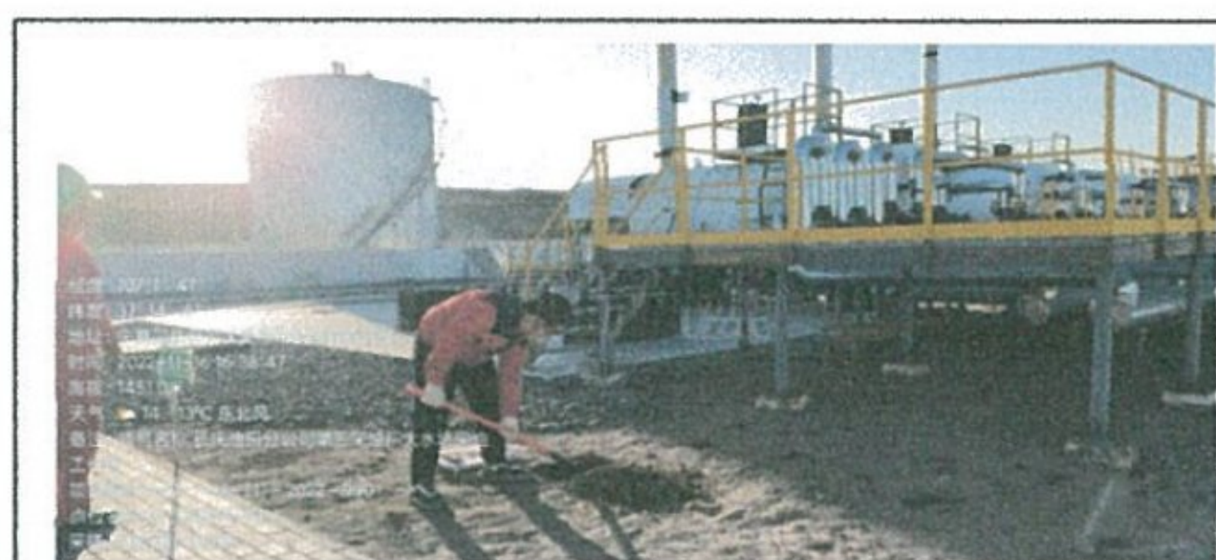
●144#: 盐二接转注水站
