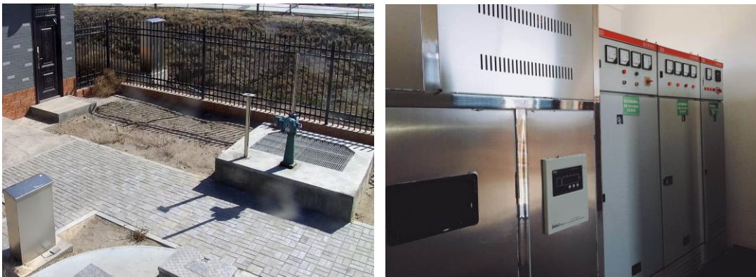
图 2-75 秦渠南一体化泵站现状图
